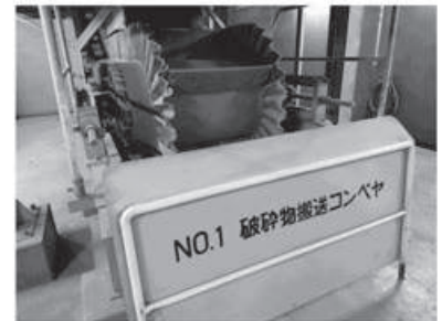
粗大ごみ処理施設 破砕物搬送コンベア
